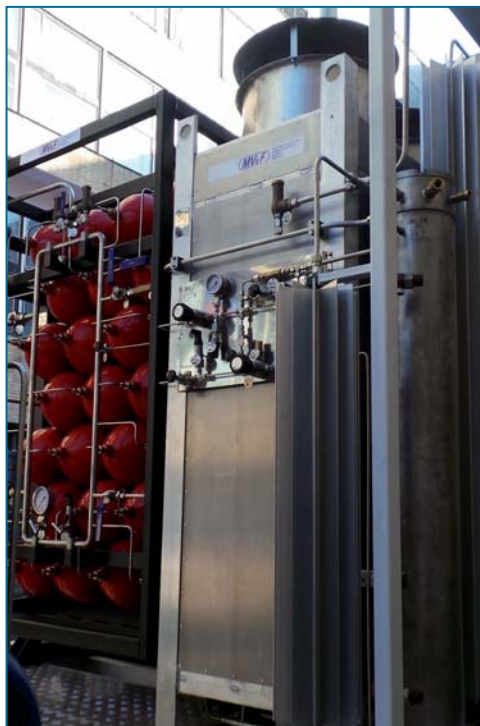
Рис. 9. Оборудование производства MV&F (БАГ, атмосферный испаритель с секцией естественной и принудительной конвекции, нагреватель электрический во взрывозащищённом исполнении) в составе мобильной СКПГ-станции
