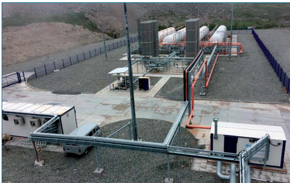
Рис. 2. Станция регазификации СПГ для подогрева воздуха в вентиляционно-калориферных установках, оснащённых оборудованием MV&F (криогенный центробежный насосный агрегат во взрывозащищённом исполнении и испарители подъёма давления)
