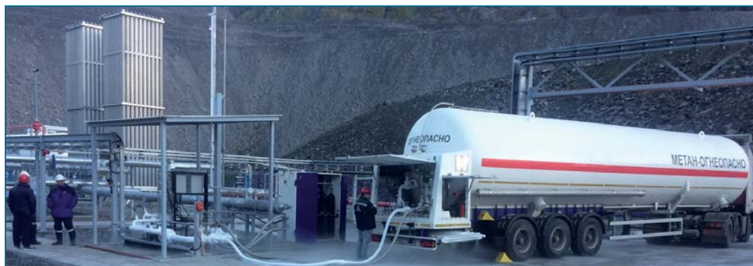
Рис. 5. Станция регазификации среднего давления. Процесс перекачивания СПГ из транспортного резервуара в стационарный с использованием криогенного центробежного насосного агрегата MV&F во взрывозащищённом исполнении
