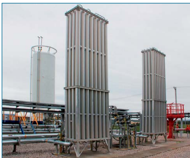
Рис. 7. Атмосферные производственные испарители СПГ среднего давления производства MV&F в составе станции регазификации (Томская область)
