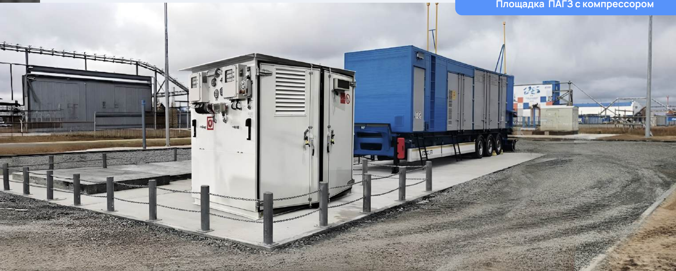
Площадка ПАГЗ с компрессором
