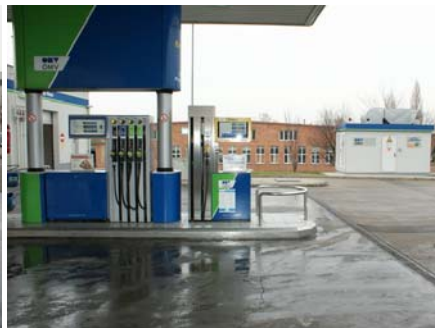
Колонка КПГ и компрессорно-аккумуляторный блок на АЗС компании OMV
